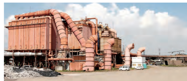
●集塵装置(筑波工場)
