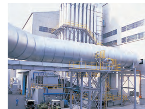
●集塵装置(石巻工場)
