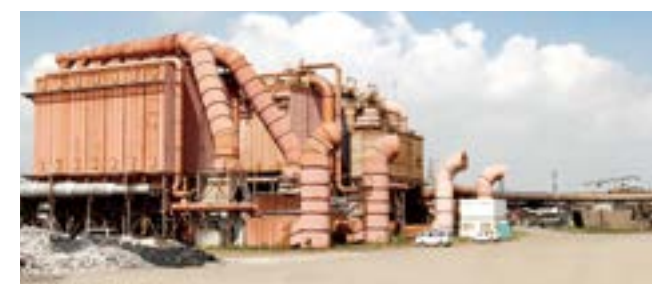
●集塵装置 (筑波工場)
