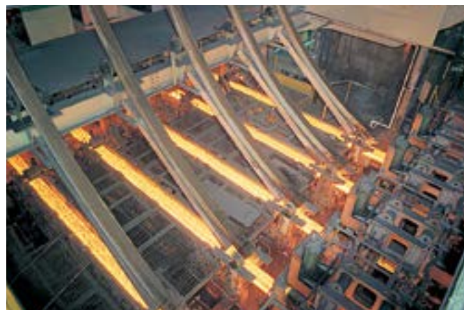
●5ストランド連続鑄造設備(筑波工場)
